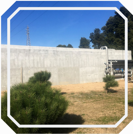
Krystaline AddI - Depósito de agua potable - Aveiro (Portugal)
